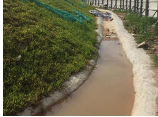
图 5.5.3.2-2 土质排水沟（表面喷砂）
