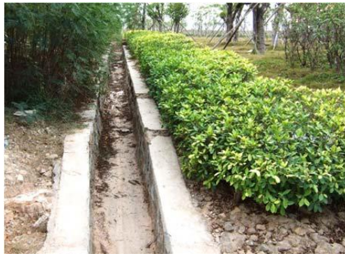
图 5.5.3.2-3 矩形浆砌石排水沟
